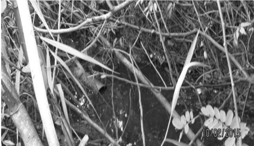
Figura 2: Lançamento de efluentes da ETE dentro do terreno.
