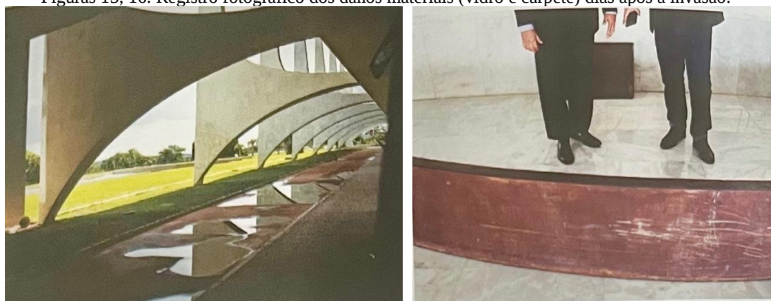
Figuras 15, 16. Registro fotográfico dos danos materiais (vidro e carpete) dias após a invasão.
